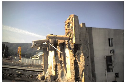
図-4.15 東日本大震災時に宮城県女川町女川浜中心部で転倒していた鉄筋コンクリート製ビルディング (基礎杭が弱過ぎたため、津波力によって簡単に折れてしまい、転倒していた稀少事例)
